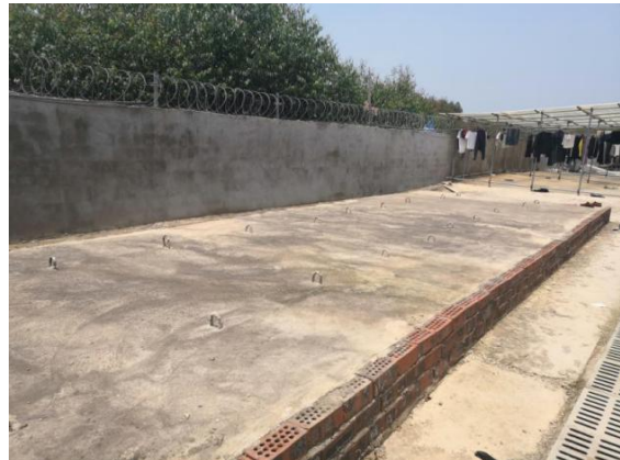
NCZQ3 标 1 号拌合站生活污水化粪池
