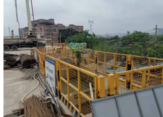
NCZQ2 标-留村隧道入口废水沉淀池
