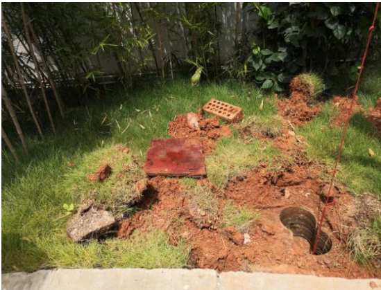
NCZQ2 标指挥部驻地化粪池
