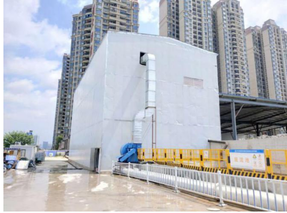
NCZQ2 标泥水处理厂整改后
