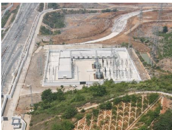
骆越牵引变电所
