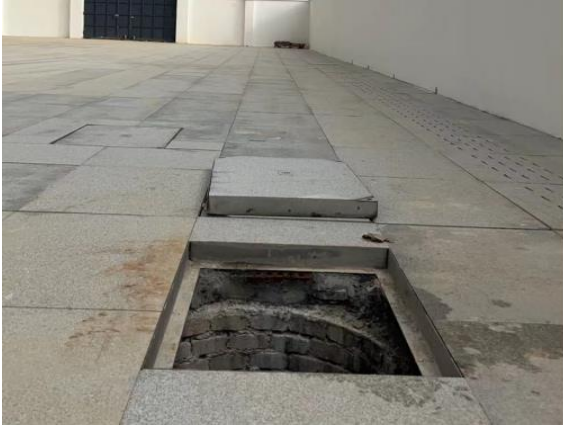
崇左南站化粪池出水排口
