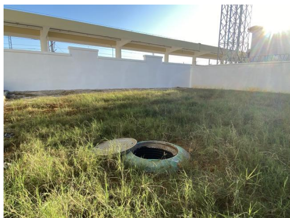
扶绥南站化粪池出水排口
