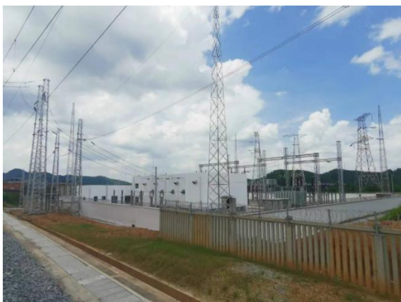
平桩牵引变电所
