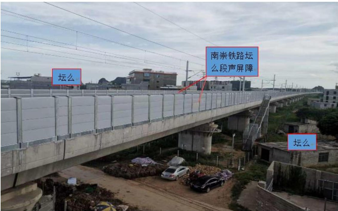
7、坛么：吴圩特大桥DK22+911.03~DK23+467.61桥梁两侧声屏障
